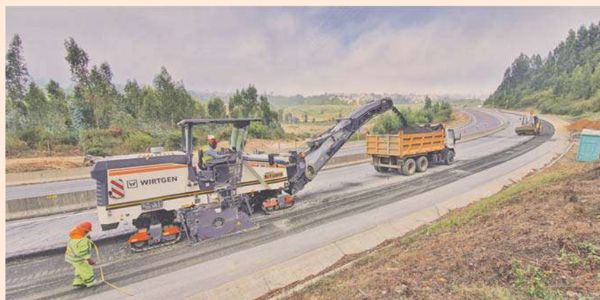
Recuperación de materiales mediante la ejecución de fresado en una obra de reciclado "In Situ" con cemento, Ruta 160 Tres Pinos – Coronel.
