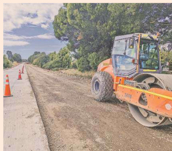
Base reciclada en la obra de Conservación Periódica Ruta 5, entre Ancud y Castro, ejecutada con áridos obtenidos tras un proceso de reciclado de hormigón.
